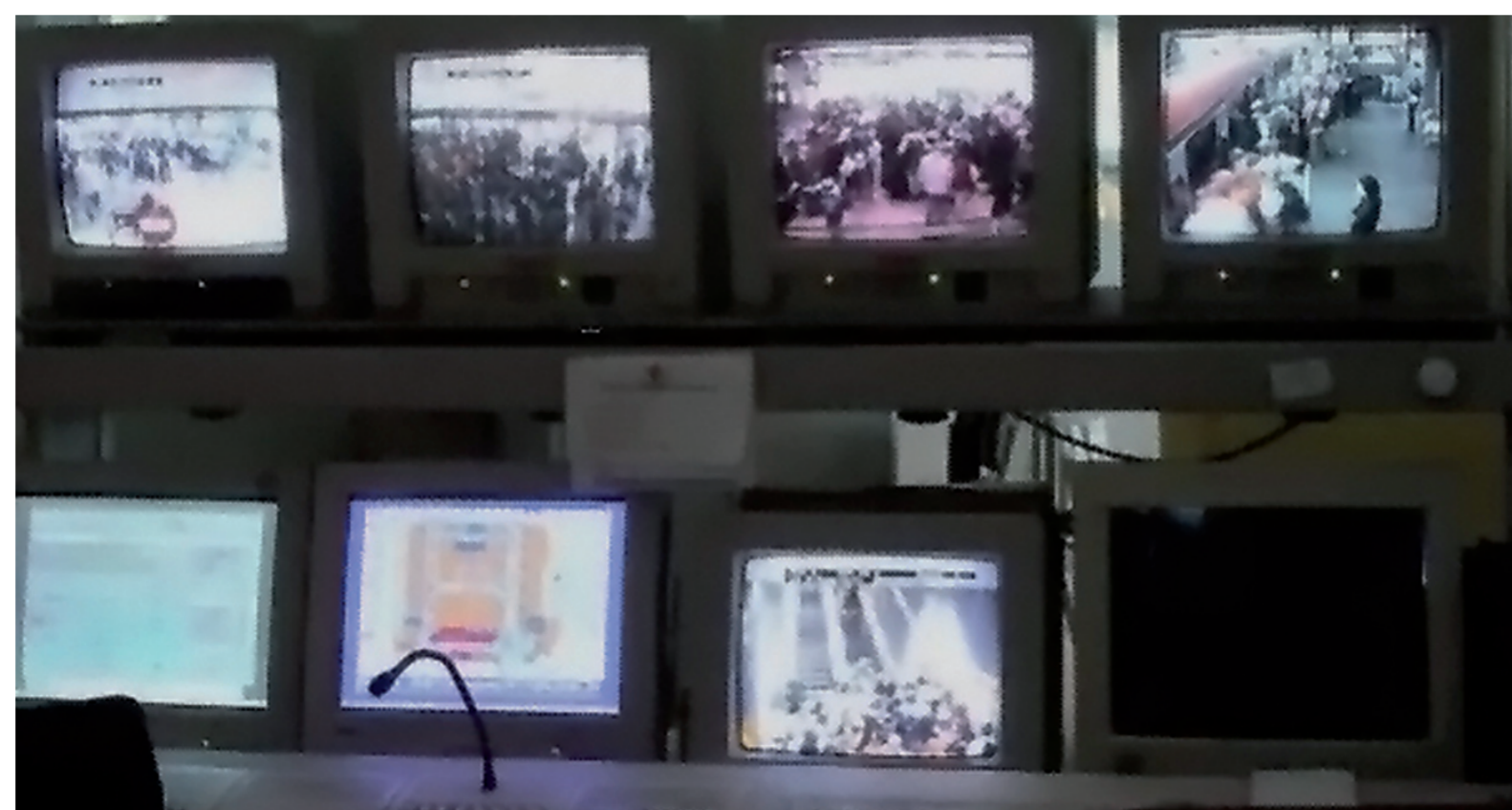
Kooperative Leitzentrale (Quelle: VeRSiert)
